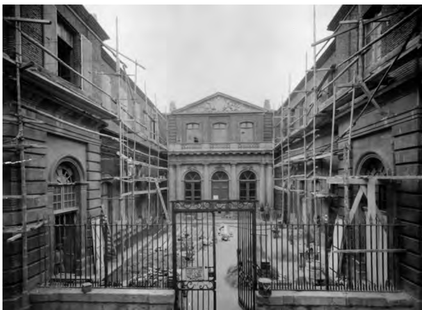
FIGURA 6. Fotografia de la campanya d'obres de restauració i de modernització de l'edifici de l'antiga Universitat de Perpinyà, 1952. © Col·lecció particular, Perpinyà.
